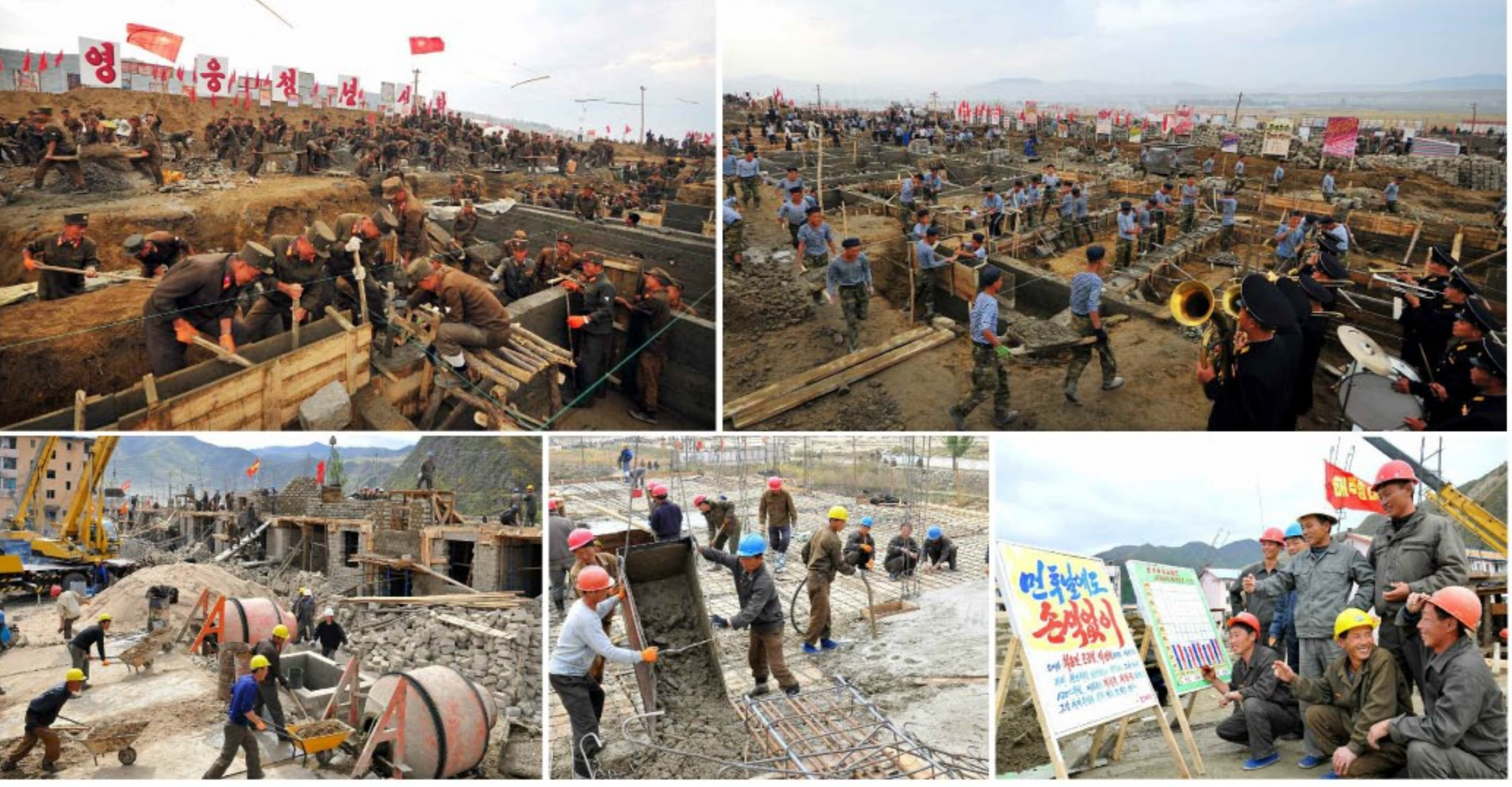
함북도 북부지역에서 진행되는 살림집건설현장의 모습. (왼쪽부터 시계방향으로) 1. 건설현장에서 일하는 군인들. 2. 건설현장에서 일하는 군인들. 3. 건설현장에서 일하는 군인들. 4. 건설현장에서 일하는 군인들. 5. 건설현장에서 일하는 군인들. 6. 건설현장에서 일하는 군인들.
