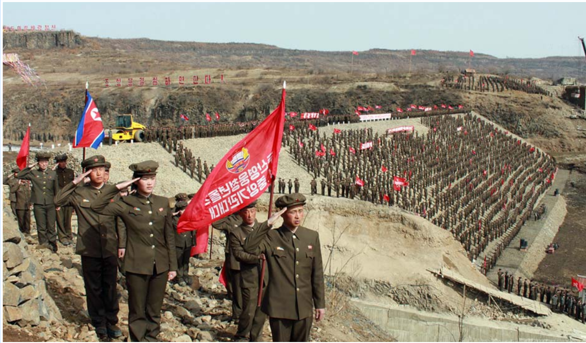
반년도 안되는 짧은 기간에 백두산영웅청년3호발전소건설을 끝내고 충성의 보고를 올리는 청년건설자들 주체104(2015)년 촬영
