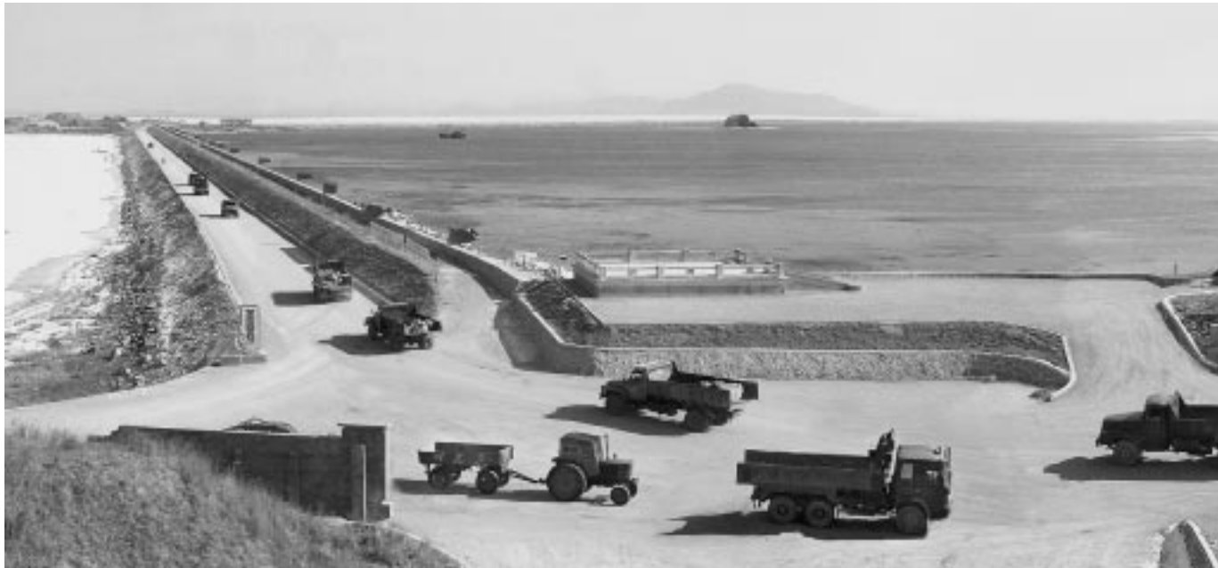
조국의 대지를 넓혀가는 간석지건설장에 혁명적기상 내려친다.
